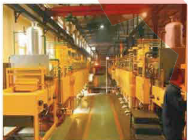
Автоматическая печь для отжига полос на сетчатом ленточном конвейере (завод 1)
